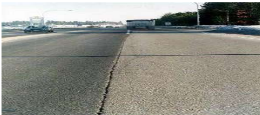
Gambar 2. 7 Retak sambungan jalan
