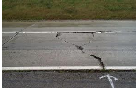
Gambar 2.4 Kerusakan retak sambungan bahu perkerasan
