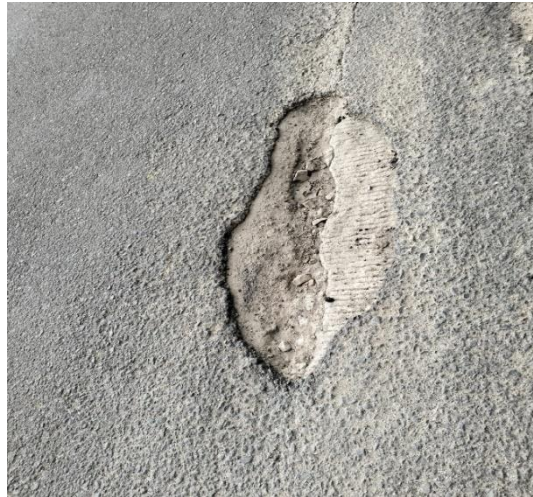
Gambar 2.7 Kerusakan retak slip
