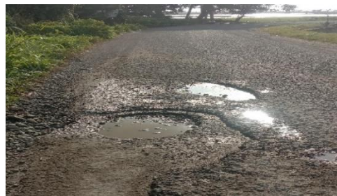
Gambar 2.10 Kerusakan sungkur Sumber : Dokumen pribadi
