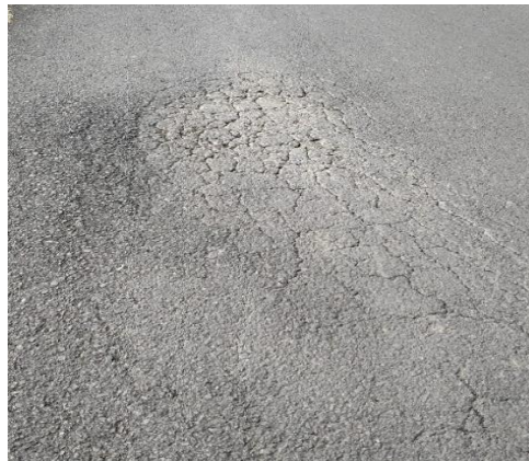
Gambar 2.1 Kerusakan retak halus
