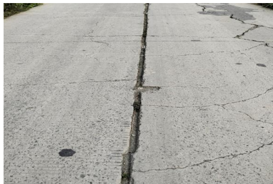
Gambar 2.5 Kerusakan retak sambungan jalan
