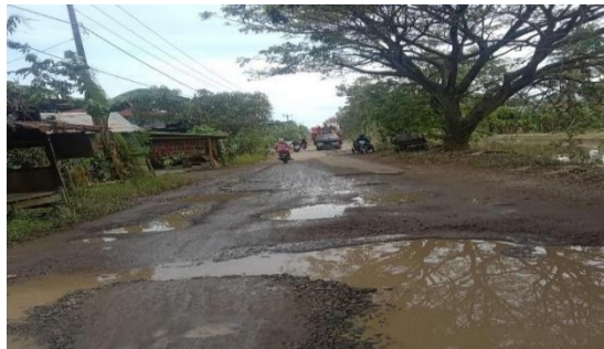
Gambar 4.9 Kondisi kerusakan jalan sebelum rehabilitasi Sumber: Survei lapangan
