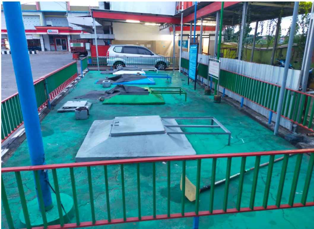
Kondisi 4 tangki pendam
