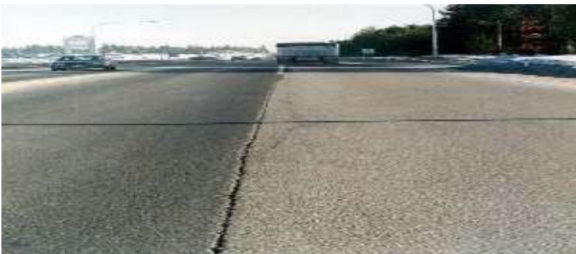
Gambar 3. 7 Retak sambungan jalan
