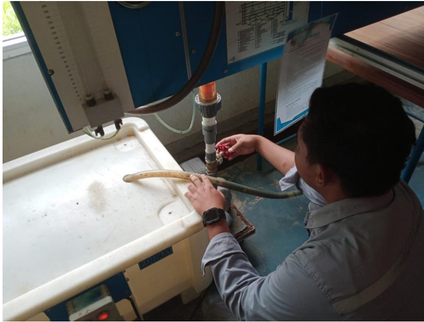
Mengatur debit yang masuk ke jaringan pipa dengan memutar klep pengatur flowmeter
