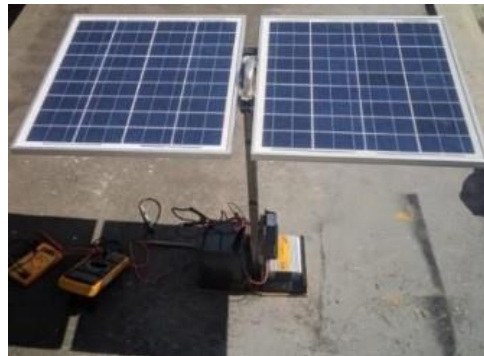
Gambar 2.8 Panel Surya ( sumber : Gunawan, 2021 )
