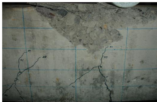
Gambar. 28 Pola retak beton additive
