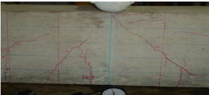
Gambar. 5.8 Pola retak beton normal
