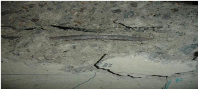
Gambar 5.11 Tulangan tekan tertekuk keatas pada beton self compacting concrete
