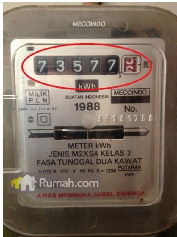
Gambar 2. 8. Meteran Listrik dengan Daya 900 VA
