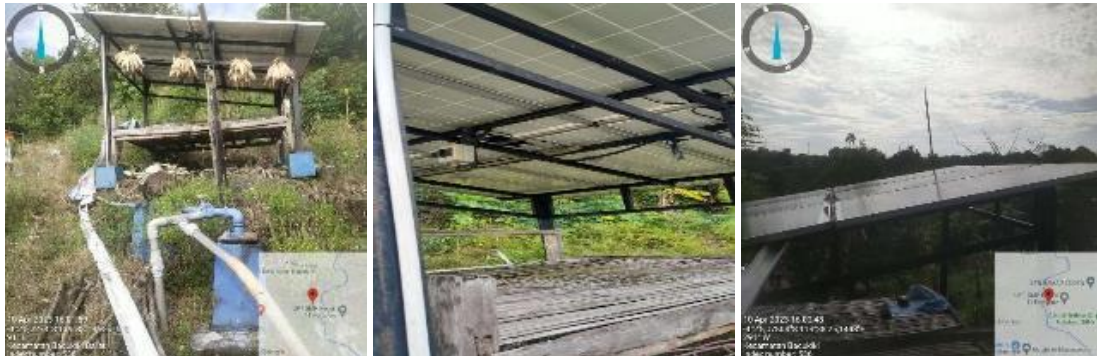
Gambar 2. Instalasi tenaga surya milik KT Barangan yang terbengkalai
